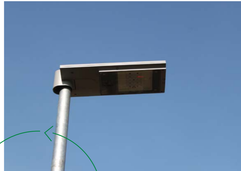
Led-verlichting in openbare ruimte.
