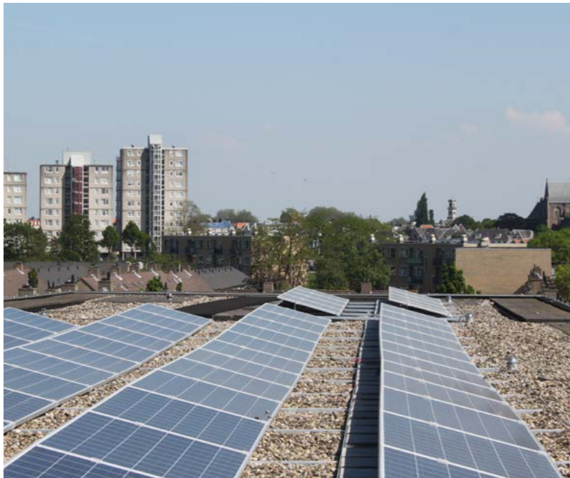
Zonnepanelen op dak gemeentehuis, initiatief Zon op Zwijndrecht.
