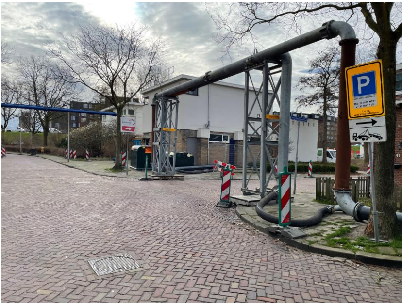
Figuur 6-4: Noodbemaling Bruinelaan
