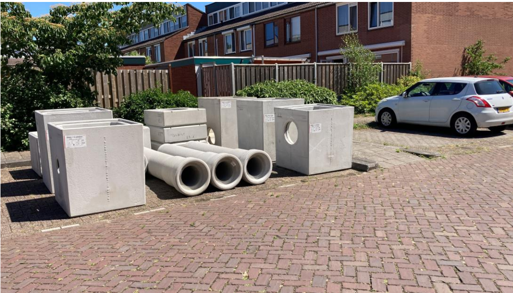
Figuur 5-8 Betonnen leidingen putten nabij Walburg
